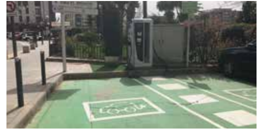
■ La nova estació de recàrrega de vehicles elèctrics de les Borges
